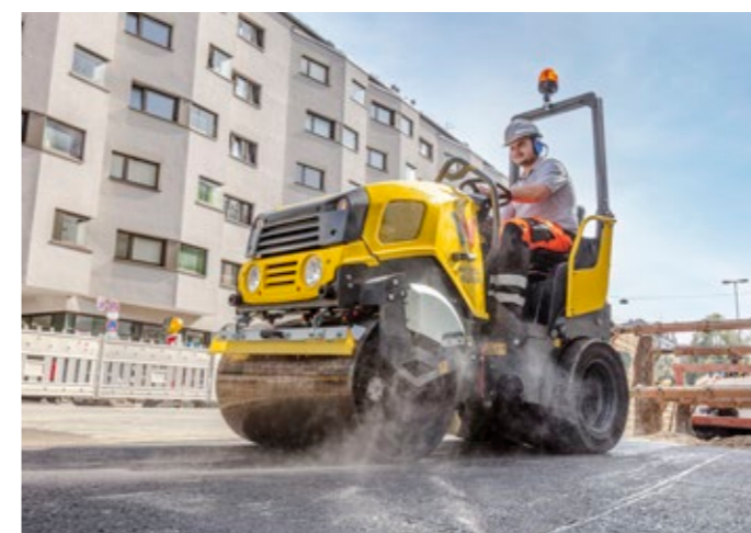
Vypasovaná konstrukce: pro volný pohled na hrany lišt, okolí stroje a staveniště.
